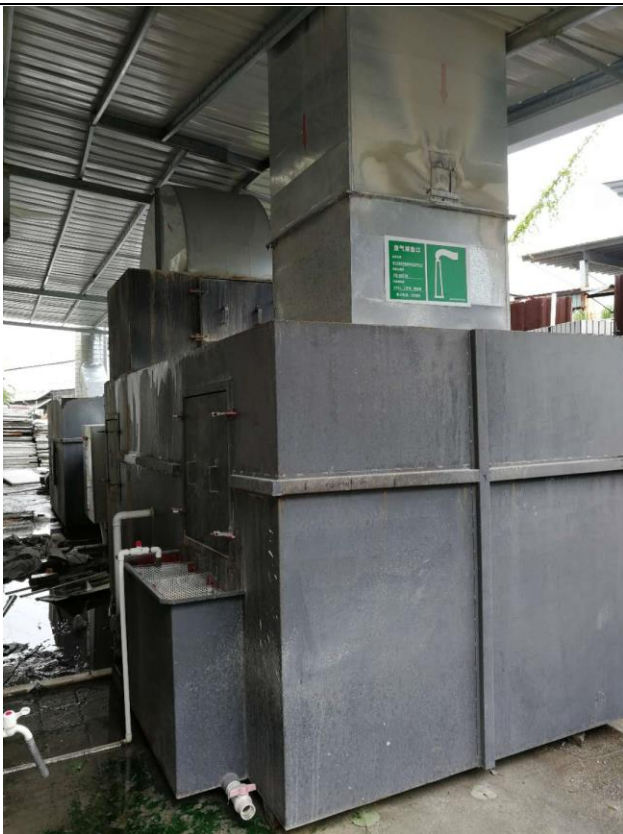
图 3-4g 项目喷漆废气处理设施
