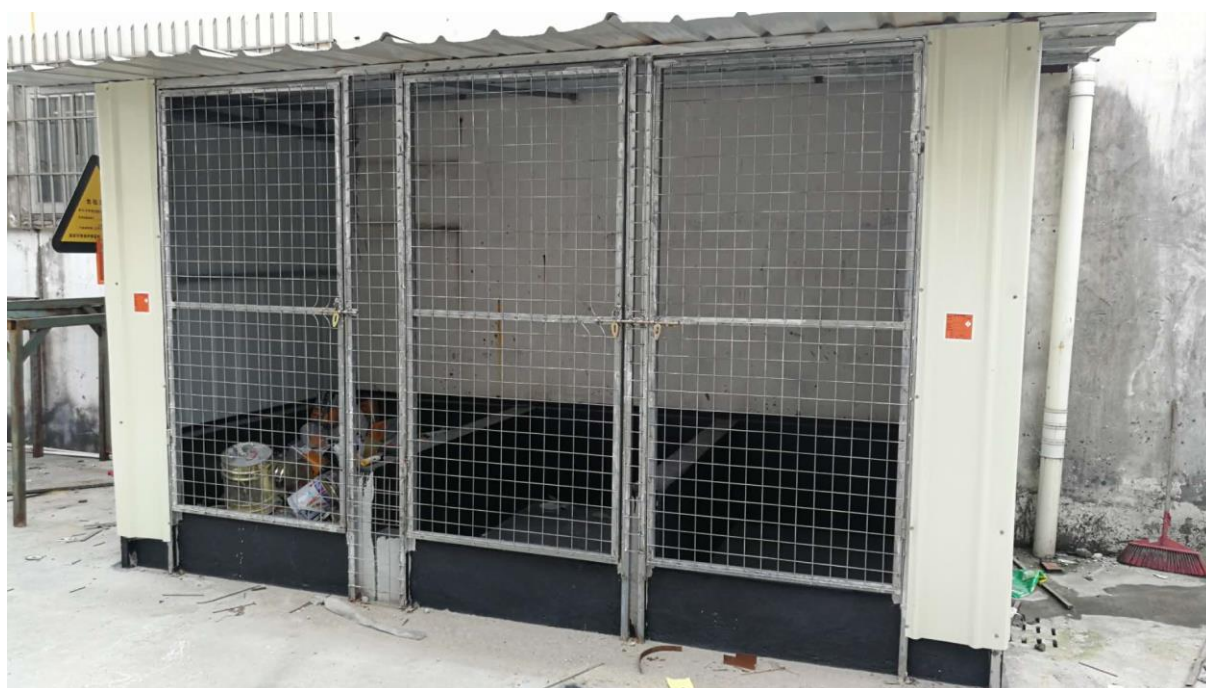
图 5-1 危险废物暂存点
